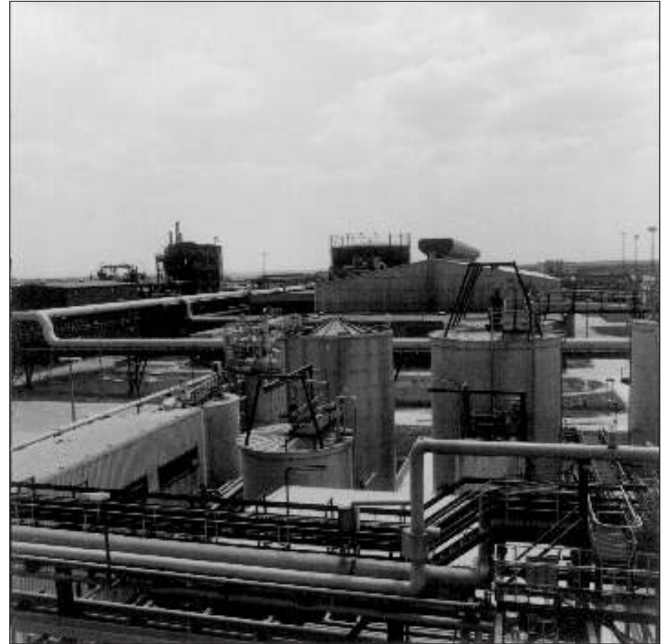
Bild 14 Übersicht über CVP mit Chlorelektrolyse und Wasserstoffbehälter in der Mitte
